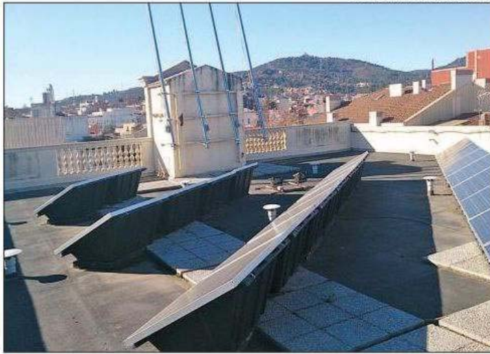
Placas solares instaladas en la azotea del edificio de la casa consistorial
