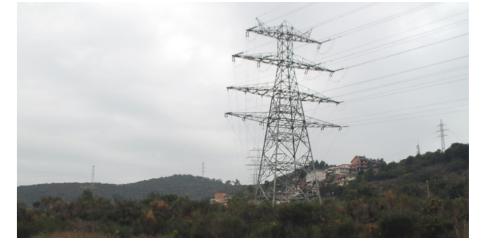
Imatge 2.4.2.2: Línies elèctriques visibles per tot el territori.
