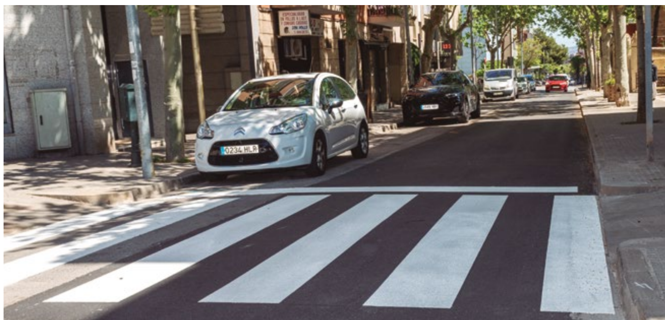
En la calle Eusebi Güell se hizo con carácter de urgencia una reparación provisional del asfaltado
